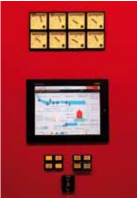
Steuerungsanlage mit Touchscreen
