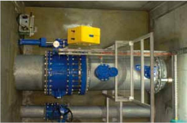
Rohrbruchsicherung und Grundablass im Reservoir
