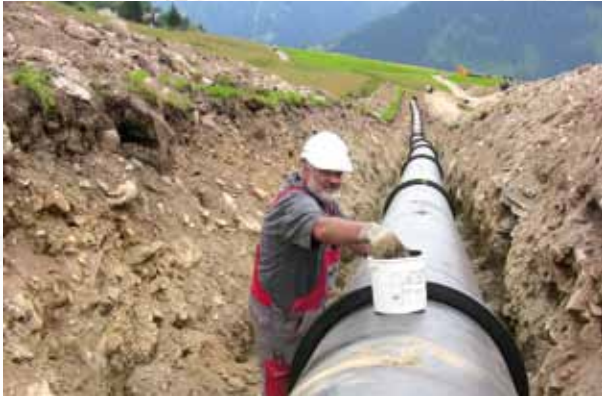
Wasserdruckleitung Durchmesser 800 mm, Länge 1'970 m
